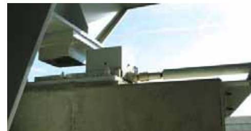
In gesloten toestand rust de brug op de opleggingen (foto boven). Voor het verplaatsen van de brug moeten de opleggingen eerst door de lineatoren worden verschoven zodat de brug kan knikken en vrijkomt van de overige opleggingen (foto onder)
