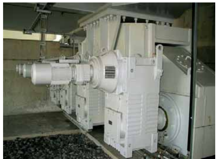
Elk wiel wordt via een industriële SEW-tandwielkast en een flexibele koppeling aangedreven door een 4 kW-motor
